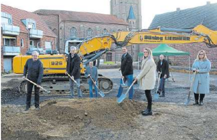
Anfang November 2020 begannen die Arbeiten am Erweiterungsbau „Haus am Kirchplatz“. Anwesend waren damals beim offiziellen Spatenstich (v. l.): Hans-Dieter Strothmann (stellvertretender Bürgermeister), Architekt Reinhold Eversmann, Burkhard Nießing (Prokurist Baufirma Schweers), Bauherr Tobias Brun, Daisy Polte, Matthias Brinkmann und Alina Hilp (alle Caritas). Foto: BZ-Archiv / Rentel
